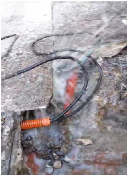
fig. 1.2 Pérdida debajo del piso
