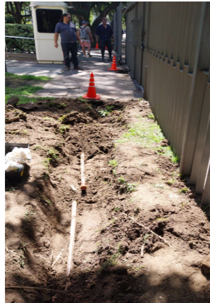
fig. 1.3 búsqueda de pérdida de agua
